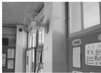
小学校の教室に設置された扇風機
